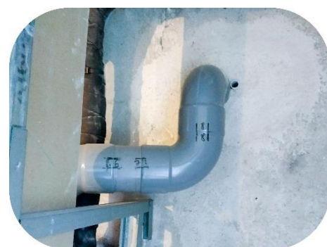
Traversée de mur du conduit et sortie extérieure du ventilateur aéralucique
